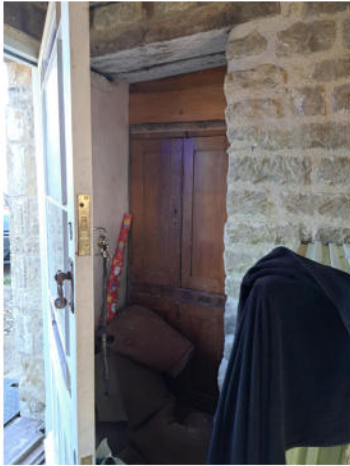
R Doors DG03 & DG10
