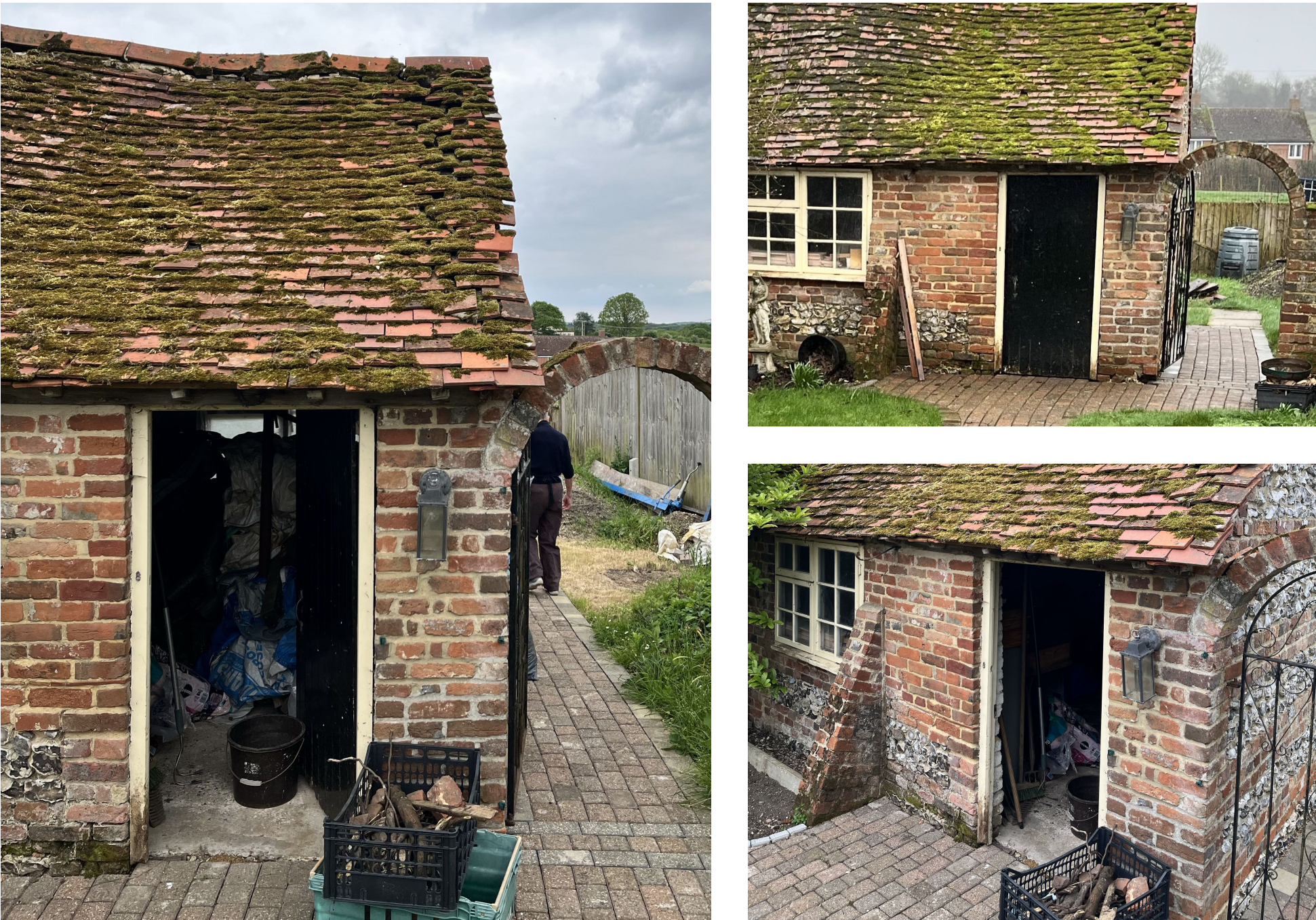
EXISTING / DECAYED DOOR FRAME
